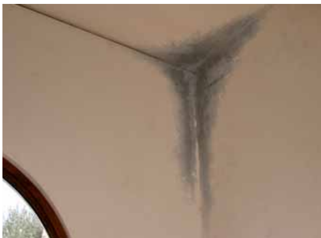
Formazione di muffe determinate dalla presenza di ponti termici.
