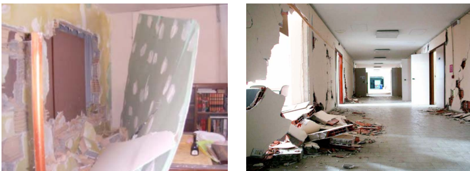
Figura 6.2. Esempi di partizioni interne danneggiati dal sisma
