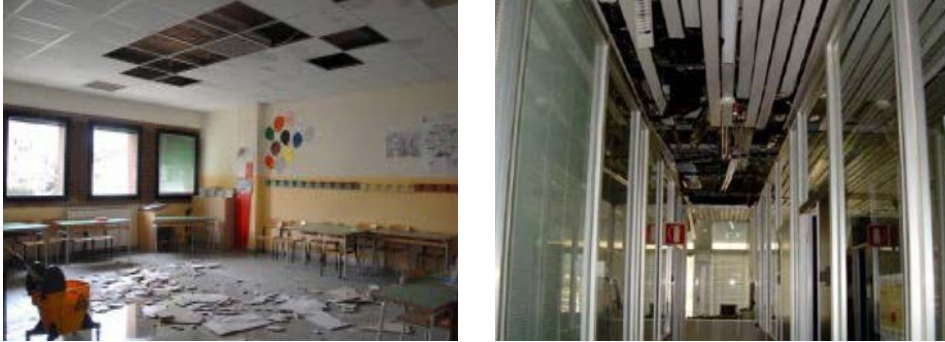
Figura 6.1. Esempi di controsoffitti danneggiati dal sisma
