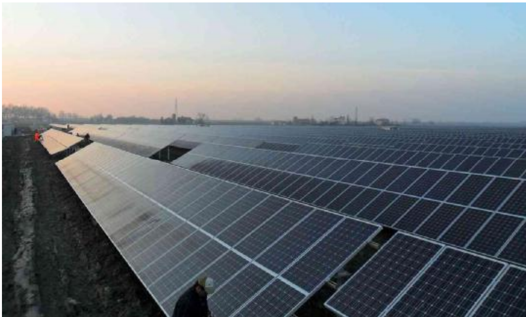
Impianto a terra
