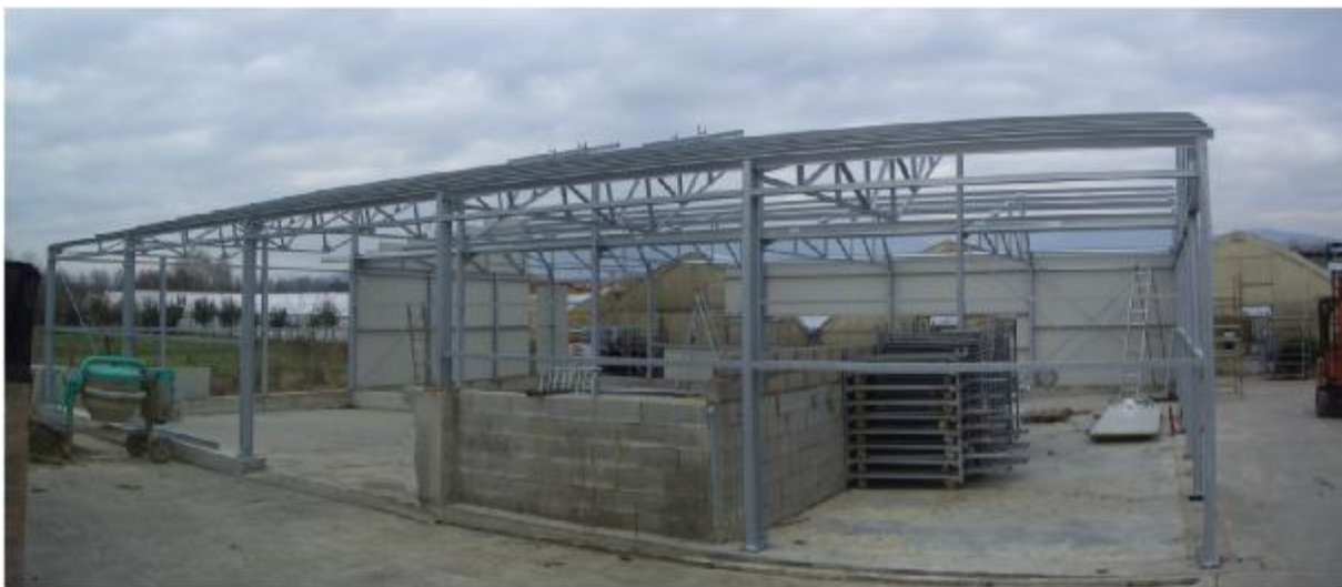
Capannone con copertura fotovoltaica
