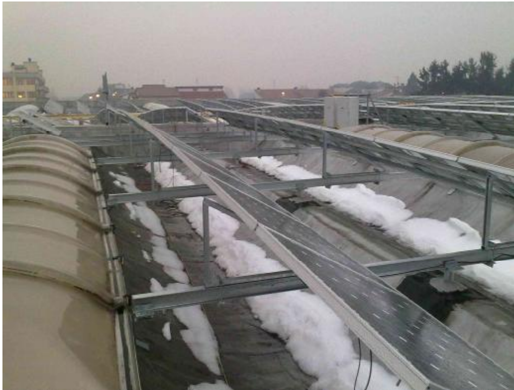
Impianto a tetto
