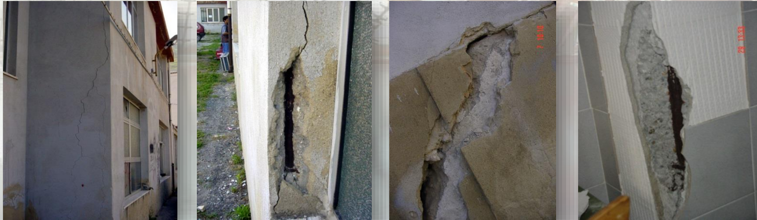
Rilievo del quadro fessurativo
