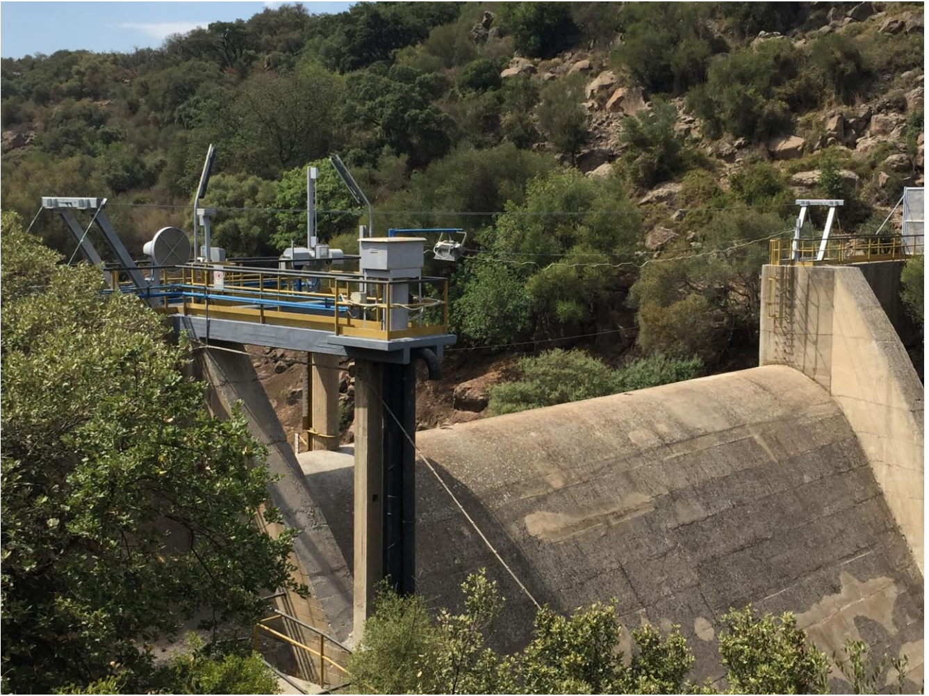
Cavi di sicurezza e telai in acciaio diga di Mulinello
