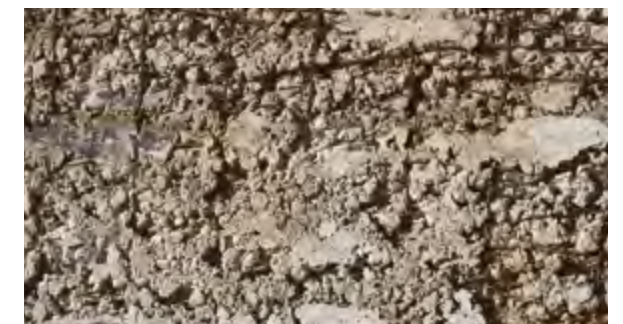
Esempio di segregazione degli aggregati nel calcestruzzo.
