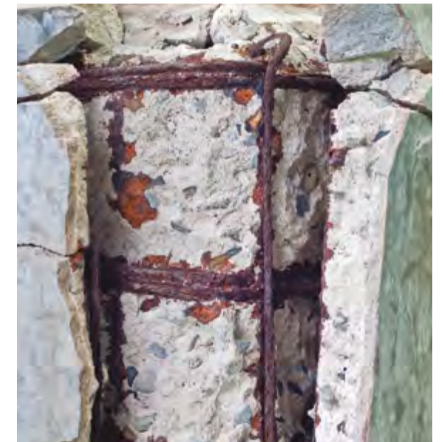
Espulsione del copriferro per arrugginimento dei ferri d'armatura.
