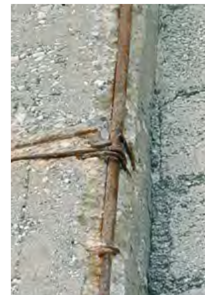
Degrado del copriferro in un pilastro in calcestruzzo.
