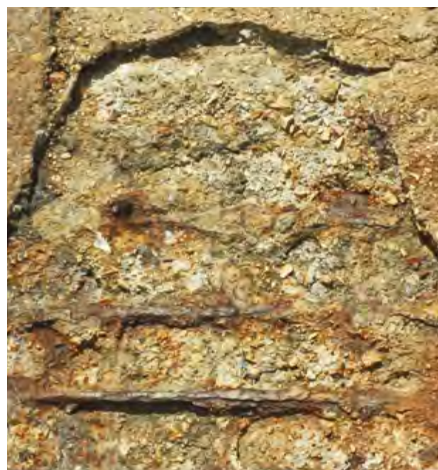
Esempio di corrosione dovuta all'attacco da cloruri.
