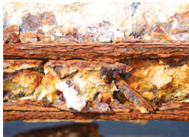
Esempio di degrado del calcestruzzo per arrugginimento dei ferri d'armatura.
