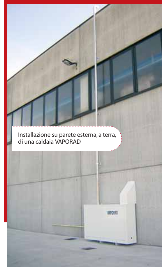
Installazione su parete esterna di una serie di caldaie VAPORAD
