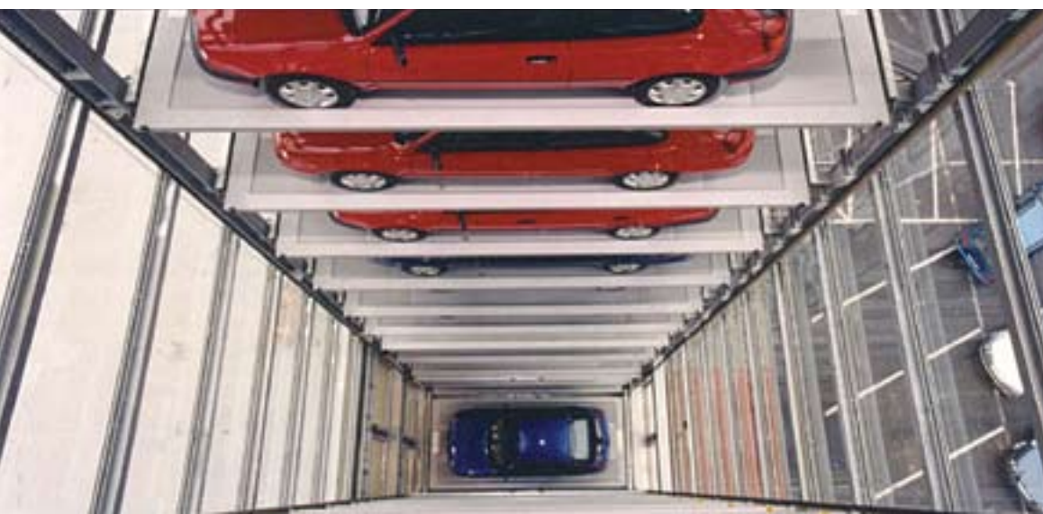
La torre per esposizione auto vista dall'interno per 65 auto disposte su 14 livelli.
