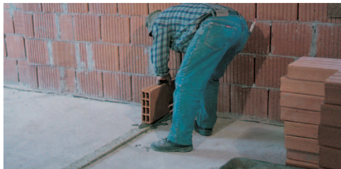
Tramezza isolata con una striscia di pannello Celenit N: intervento semplice ma efficace per interrompere la trasmissione dei rumori ai piani inferiori e ai locali adiacenti.
